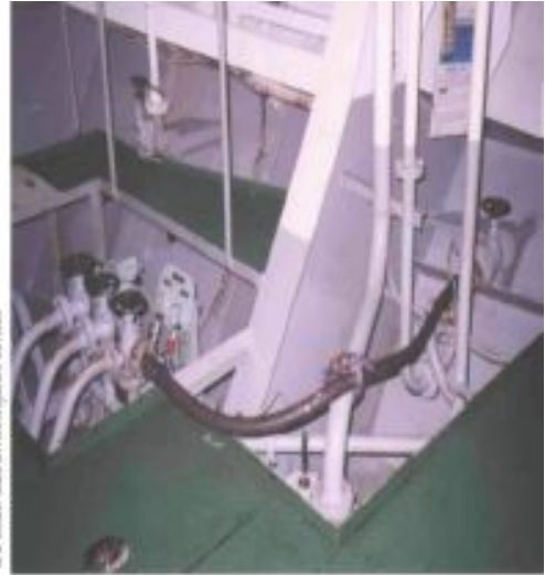
18. Manguera de derivación conectada directamente del colector de sentina a la válvula de descarga al mar.
