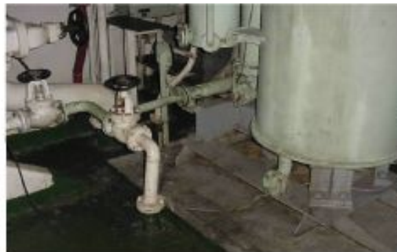
16. Tubo de derivación entre las tuberías de descarga del dispositivo sanitario marino.
