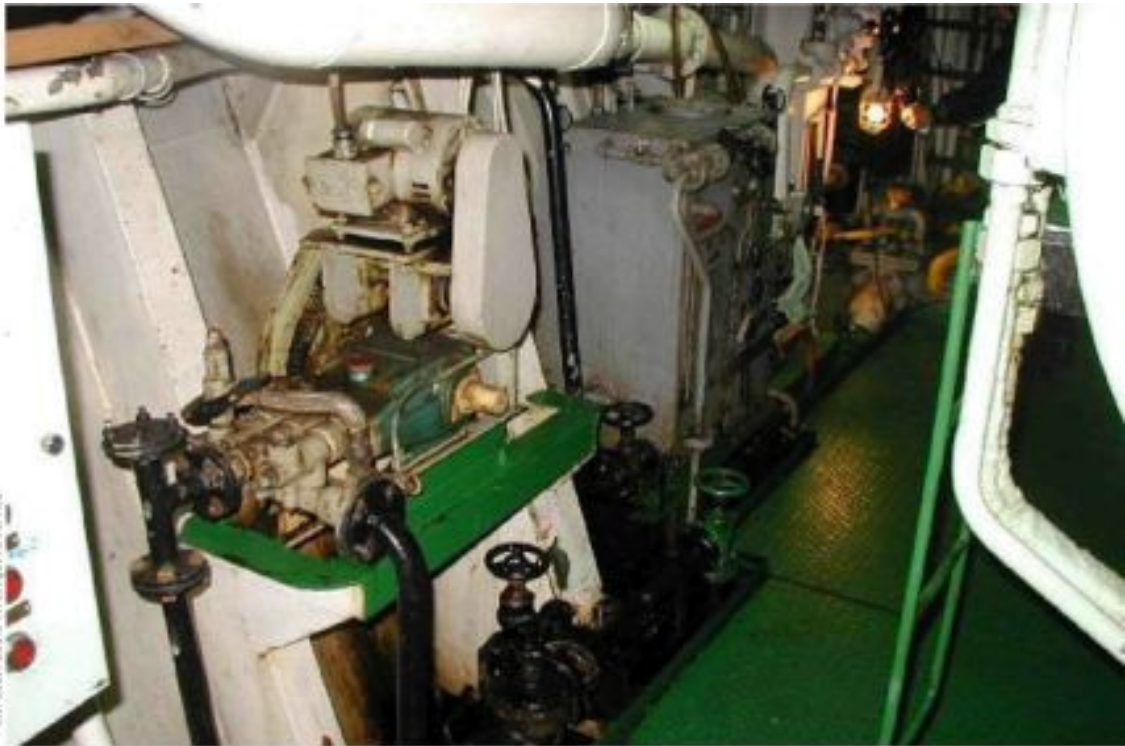
9. Brida ciega en el lado de descarga de la bomba de sentina
