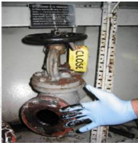
10. Restos de hidrocarburos en el interior de las válvulas de descarga al mar
