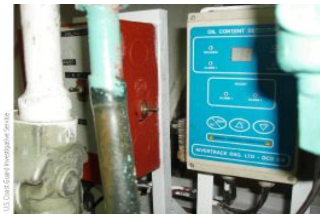
21. Interruptor de derivación instalado para silenciar la alarma del hidrocarburómetro y permitir que el separador de agua e hidrocarburos siga funcionando incluso si el contenido en hidrocarburos excede 15 partes por millón.
