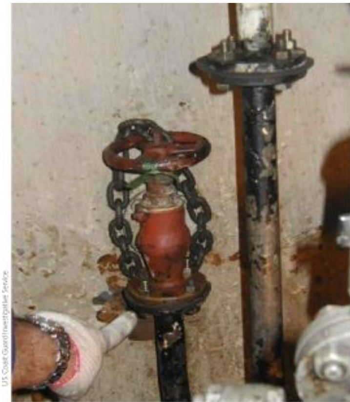
19. Indicios de que se han desmontado reiteradamente las tuberías conectadas a la válvula de descarga al mar. Obsérvese que la utilización de una cadena y un candado no impide las descargas ilícitas, sino que reduce la probabilidad de que se produzcan descargas accidentales.
