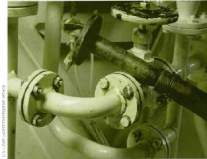
17. Las bridas del tubo flexible con restos de hidrocarburos coinciden con los conductos de la válvula de descarga al mar.
