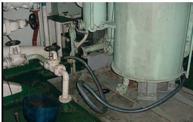
15. Dispositif de traitement des eaux usées équipé d'une tuyauterie de décharge à la mer des eaux usées.
