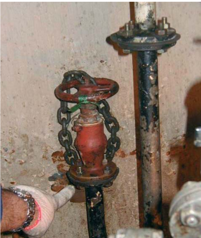
19. Traces de démontages répétés de la tuyauterie raccordée à la vanne de décharge à la mer. On notera que la mise en place d'une chaîne et d'un cadenas n'empêche pas les rejets illicites. Elle permet simplement de conclure que ces rejets ont moins de chances d'être accidentels.
