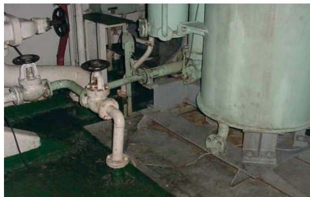
16. Tuyau flexible de dérivation raccordant le circuit d'assèchement des cales à la tuyauterie de décharge à la mer du dispositif de traitement des eaux usées.
