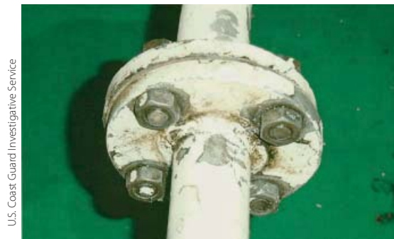
20. Peinture écaillée et usure des boulons.
