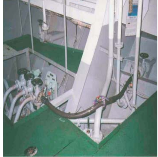
18. Tuyau flexible de dérivation raccordant directement le collecteur des eaux de cale à la vanne de décharge à la mer.
